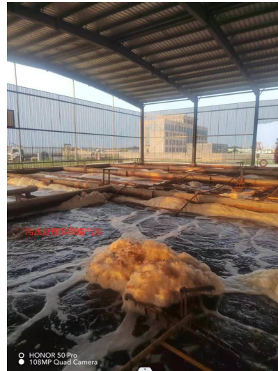
污水处理曝气池
