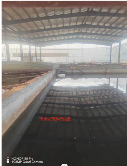
污水处理系统全景
